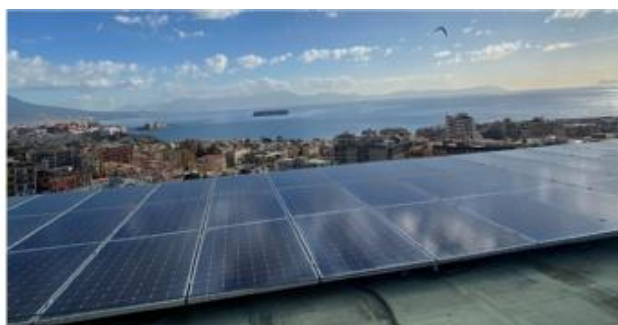
Figura 48. Impianto fotovoltaico installato
