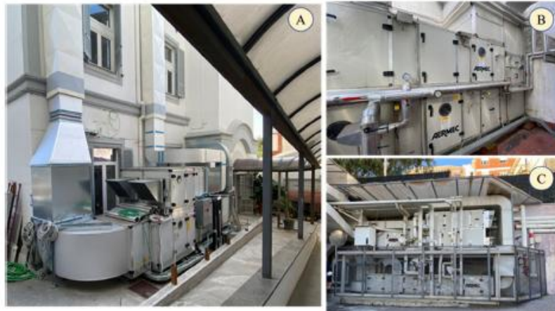
Figura 47. Unità di trattamento dell'aria principali: (A) (piano-1) radiologia; (B) (2° piano) sala parto; (C) (3° piano) assistenza infermieristica del nido
