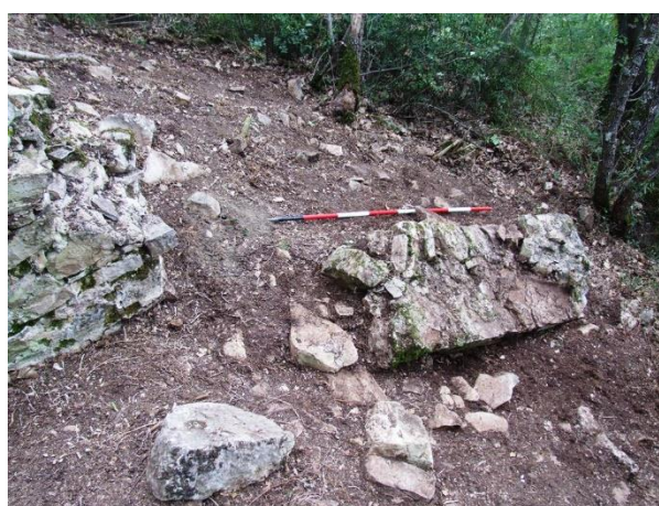
Fig. 95. Tratto crollato (usm 1005) del muro di sostruzione del terrazzamento superiore.
