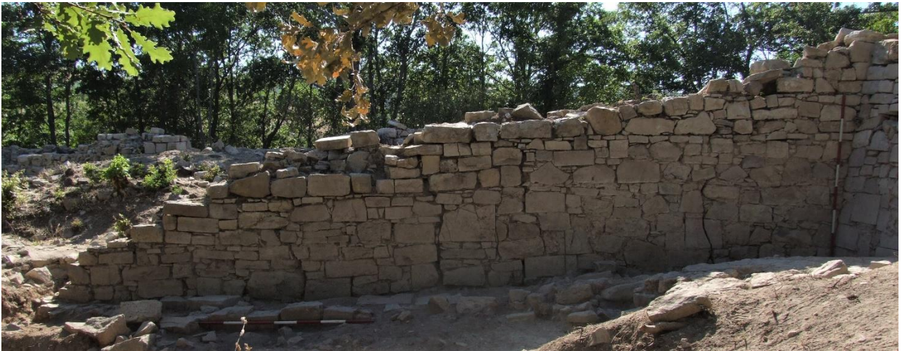
Fig. 324. Facciavista est del perimetrale destro della navata centrale (usm 1505) con segni di lesioni strutturali.
