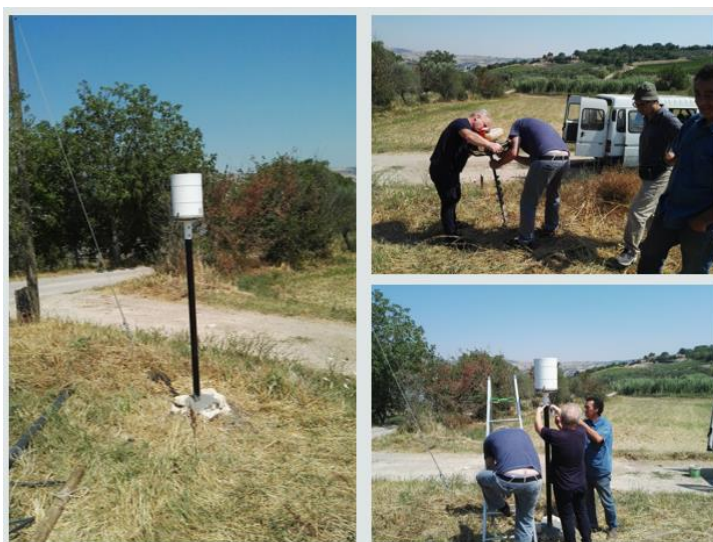
Figura 5.46 - Installazione del pluviometro presso la Masseria Franciosa (Torrecuso)
