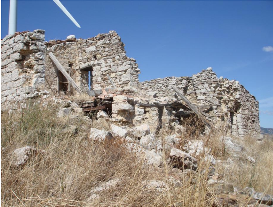
Figura 113. Taverna in completo stato di abbandono lungo il tratturo Castel di Sangro – Lucera nel comune di Lucito.
