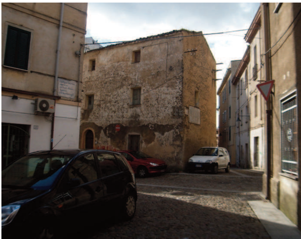
Nuoro , abitazioni “ a palattu ”. Nella foto in basso, è documentato uno dei più interessanti per morfologia e caratteri costruttivi, per nulla viziato da “abbellimenti” decorativi di stile Déco.
