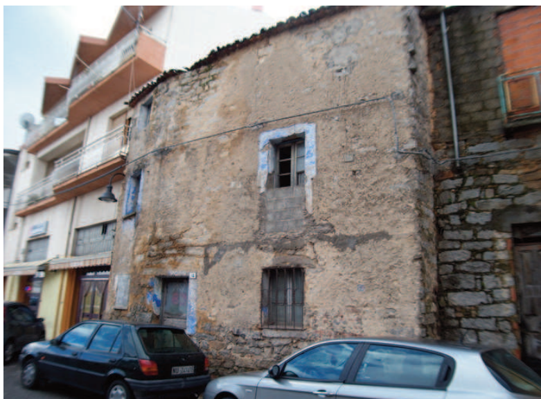
Forni , edificio tradizionale abbandonato, oggi compresso dai nuovi. La tonalità celeste che contorna gli stipiti e l'architrave di alcune aperture, stesa sulla calce un tempo tenuta solo bianca, denota come l'interesse per queste costruzioni si risvegli in occasione delle sagre paesane (per Cortes Apertas i fonnesi hanno ripetuto l'operazione applicativa del celeste sui fabbricati superstiti del centro storico), cioè quando essi diventano memorie attrattive turistiche.
