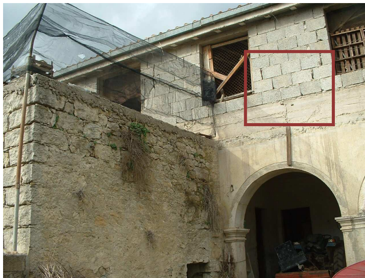
Figura 47: L'immobile di Gesturi: evidente l'utilizzo di materiali impropri quali i blocchi in calcestruzzo (Fonte: Progetto Posadas)
