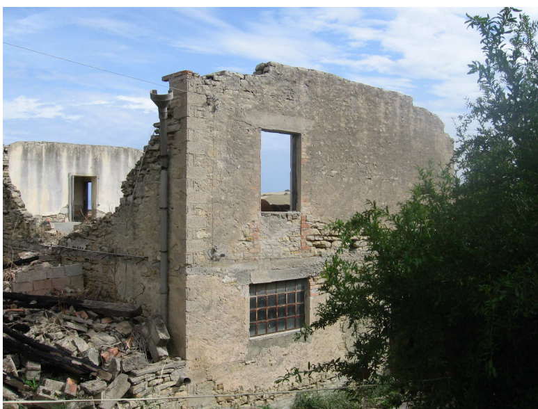
Figura 51: L'edificio di Villanovafranca: evidenti segni di crolli strutturali (Fonte: Progetto Posadas)
