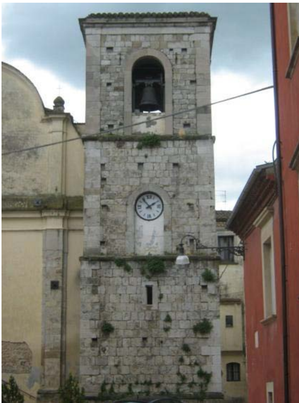
Figura 33: Il Campanile della Chiesa di S. Maria della Pietà in Larino con la tipologia muraria in evidenza
