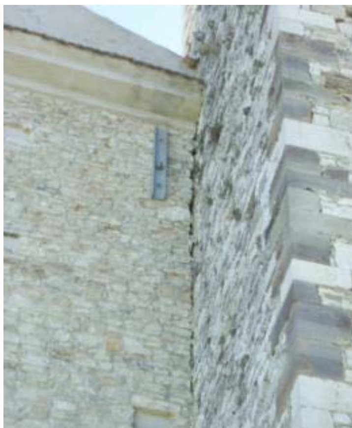
Figura 14: Morrone del Sannio, Chiesa di S.M. Maggiore: Muratura ben ammorsata, giunto tra campanile e chiesa
