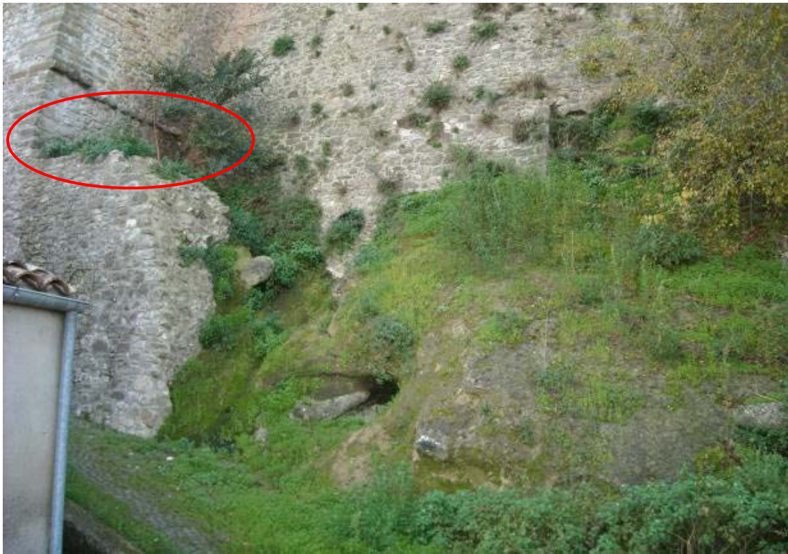
Figura 60: Castello Di Capua in Gambatesa: Banco di tufo affiorante su cui fondano le pareti ed indicazione dell’arco abbattuto
