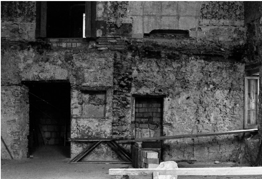
Figura 76: Palazzo Mazzarotta in Campobasso: Assenza di connessione tra le pareti. (foto: Soprintendenza BAP Molise)
