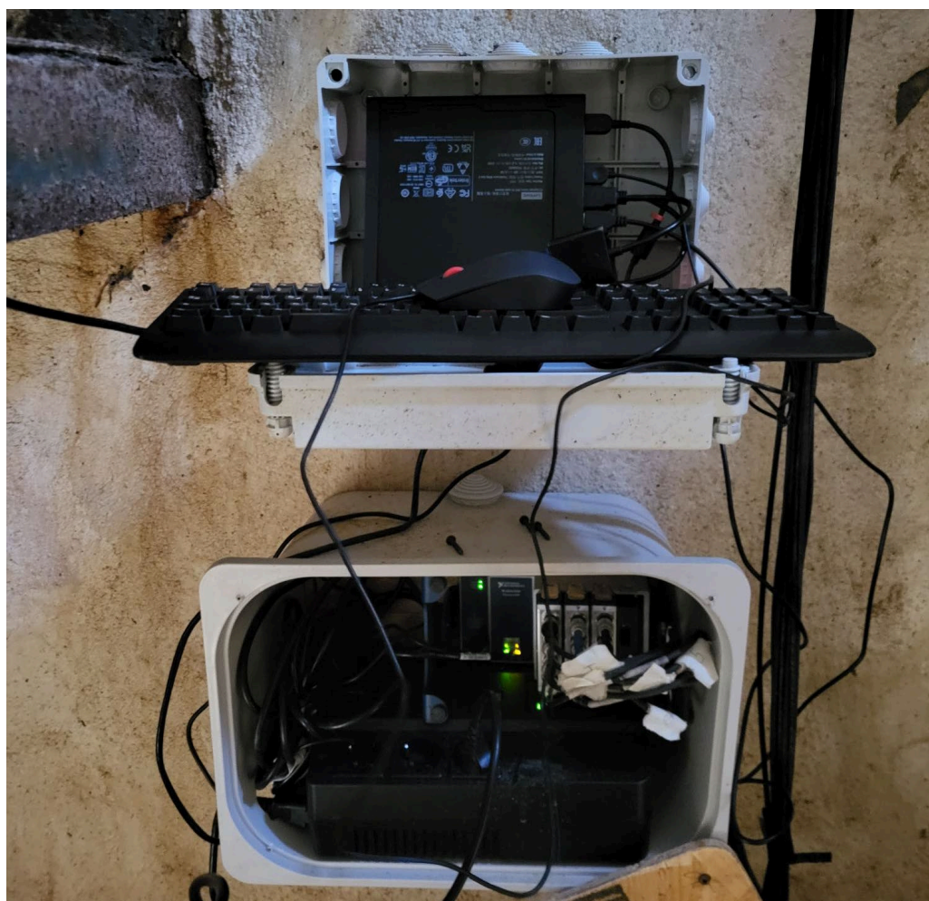
Figura 2.13. Sistema di acquisizione.
