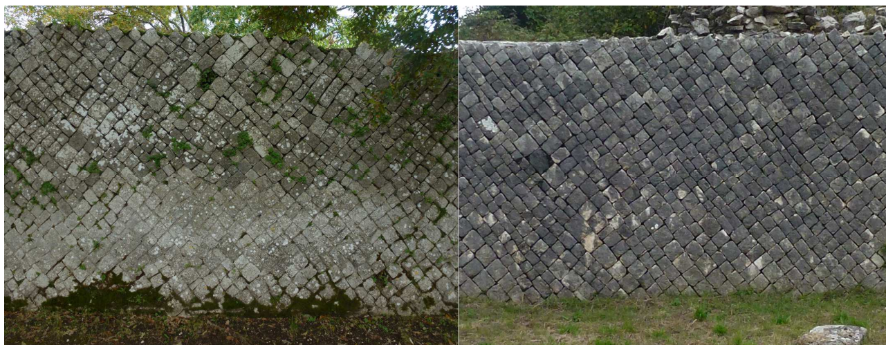
Figura 53 - Nell'immagine di sinistra un tratto di intervento di restauro attribuibile agli anni '50 mentre a destra quello riferibile ai restauri degli anni 2000-2002. In quest'ultimo sono evidenti i ricorsi obliqui realizzati utilizzando per ogni strato elementi della stessa altezza eseguito non in senso orizzontale ma allestendo i conci per strati obliqui.
