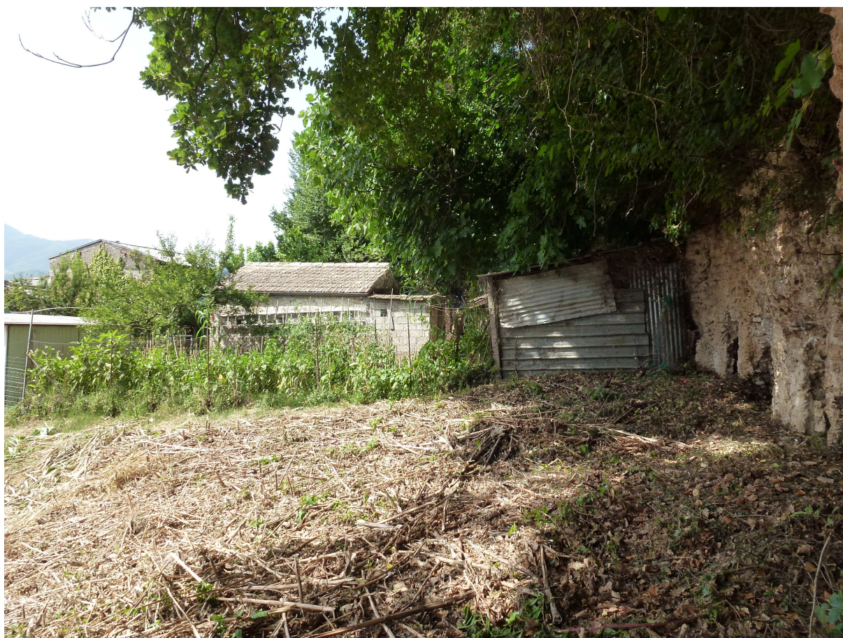
Figura 27 - Attuali condizioni in cui riversa una parte dell' odeon .
