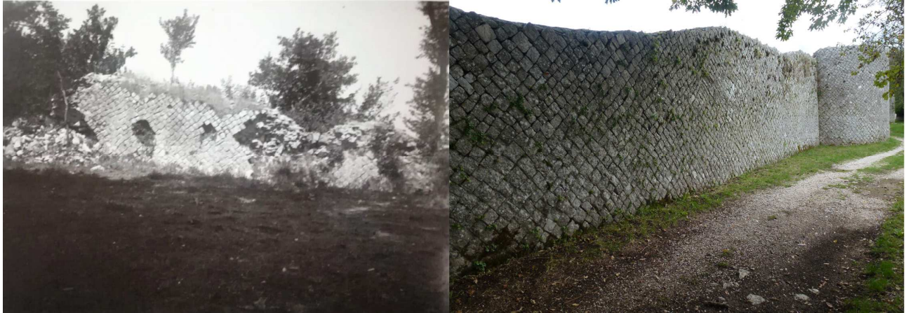
Figura 50 - Restauro di un tratto murario della cinta urbana. La cortina ricostruita è restaurata con lo stesso materiale proveniente dai crolli. E' possibile rilevare in questa immagine come la torre sia stata completamente ricostruita.
